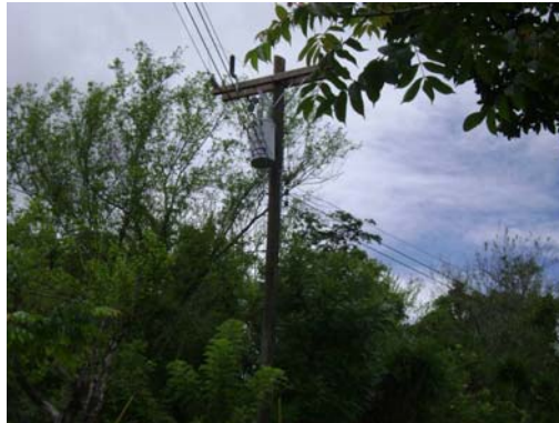
La imagen muestra uno de los postes de electrificación utilizados para este proyecto.
