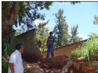
Sección del Muro Perimetral derribado.
