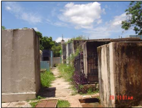
Humedad en los nichos debida a la falta de mantenimiento
