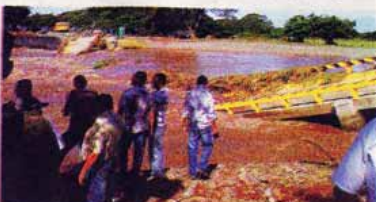
Las investigaciones por parte del TSC sobre el puente de Los Amates comenzaron el martes.
