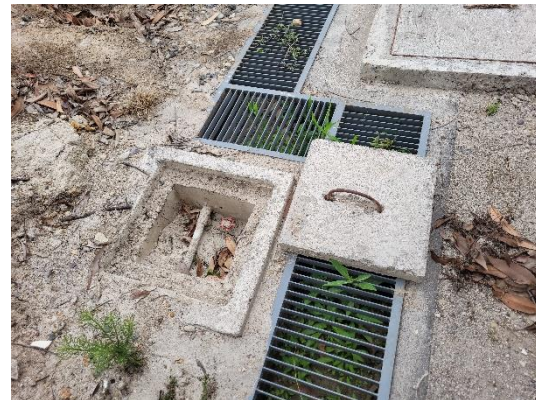
Ilustración 8-. Cuneta y Caja de Registro
