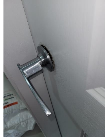
Ilustración 7- Llavín en mal estado
