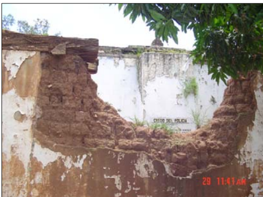
Fotografía 5. Oficina en mal estado, presentando el muro derribado e inexistencia de techo.
