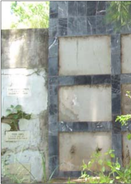
Fotografía 7. No existe separación entre estos dos nichos.
