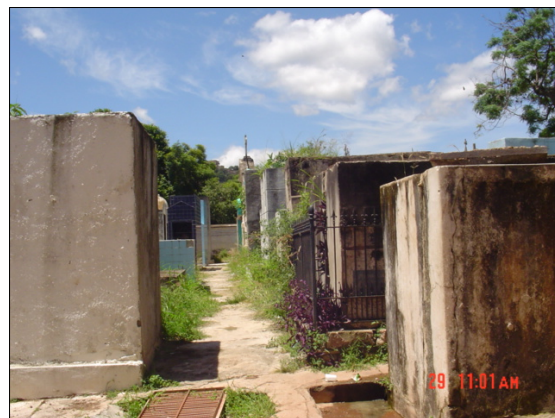
Fotografía 10. Humedad en los nichos debido a la falta de mantenimiento.
