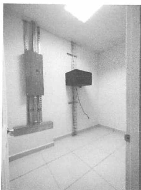
Imagen de Cuarto eléctrico Segundo Nivel”
