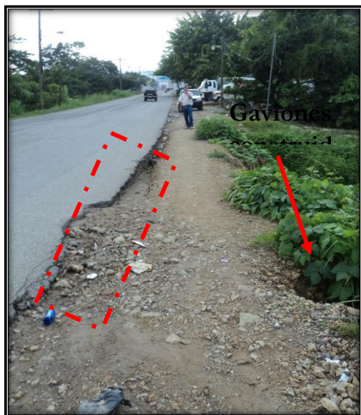
Ilustración 6- Surco Lateral Derecho de la Calzada
