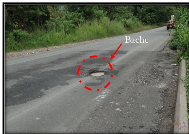
Ilustración 9- Falla en el pavimento (Bache)
