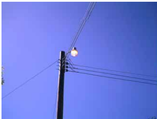
La imagen muestra un poste de energía en la comunidad de Agua Caliente
