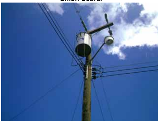
La imagen muestra un poste de energía eléctrica con su transformador en la comunidad
