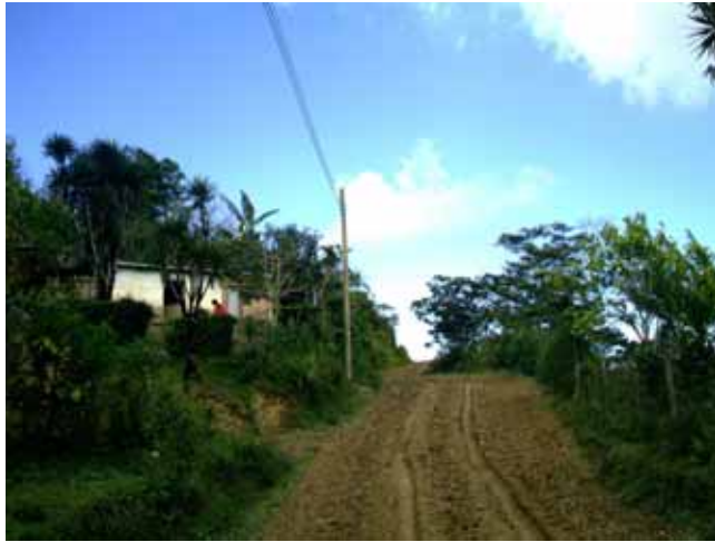
La imagen muestra el tendido eléctrico de la comunidad de Unión Cedral
