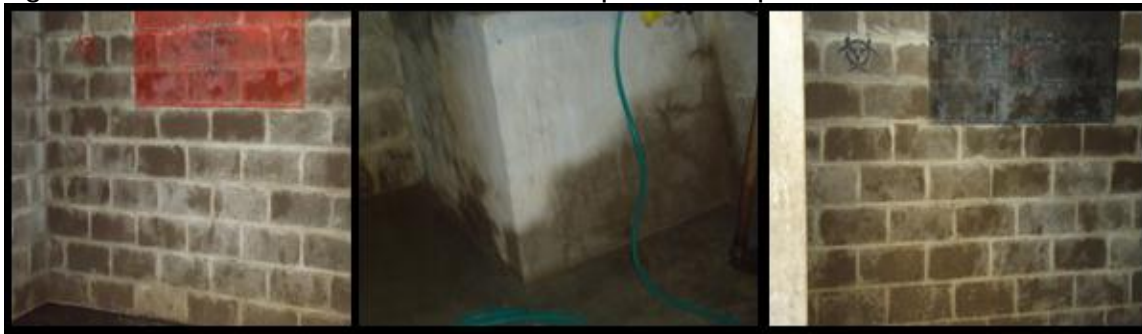
Imagen N° 7. Obsérvese que el almacén temporal de desechos no cumple con algunas especificaciones establecidas en el Reglamento creado para tal fin.
