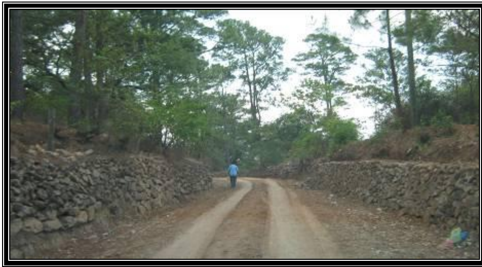
La imagen nos muestra los trabajos realizados en la reparación de la carretera que conduce a la Aldea El Vino
