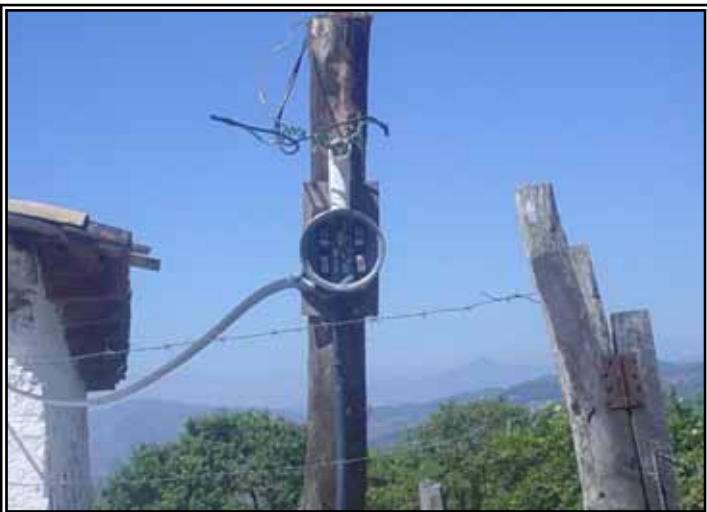
La imagen muestra las casas con su respectiva caja donde se colocara el contador en esta comunidad de Potrerillos
