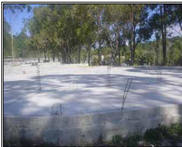
Imágenes del avance de la Construcción de la Plaza Artesanal en el Barrio Santa Teresa.
