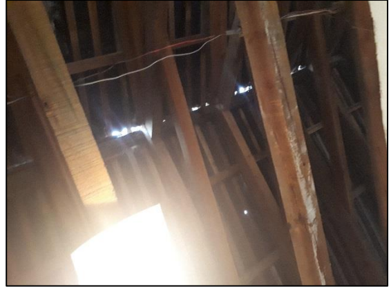
Imagen N° 6 Techo en mal estado
