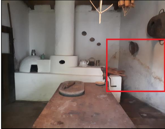
Imagen N°5 Filtración de agua por las paredes.
