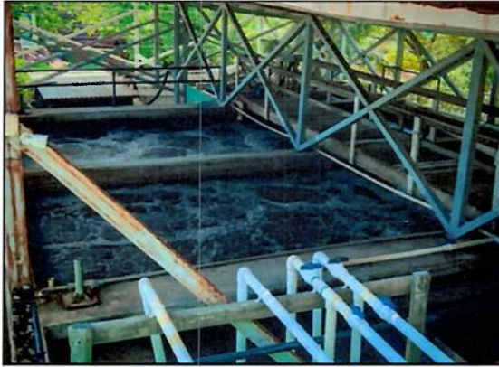
Ilustración 11. Planta de Tratamiento de aguas residuales ubicada en West End
