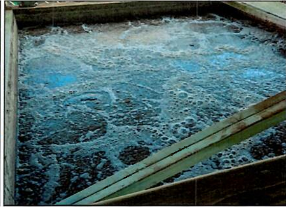
Ilustración 12. Planta de Tratamiento de aguas residuales ubicada en West End
