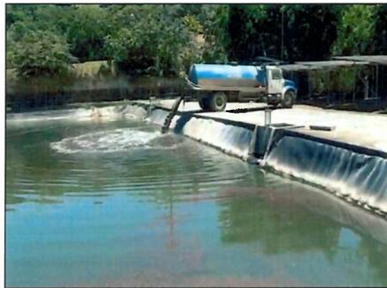
Ilustración 13. Descargas directas en las lagunas de aireación de la Planta de Tratamiento de aguas residuales ubicada en Coxen Hole
