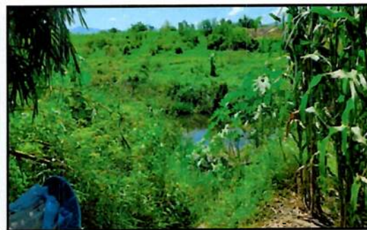
Ilustración 33. Necesidad de reparación de alcantarilla en Canal Camping
