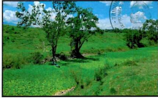
Ilustración 46. Falta de mantenimiento de ancho de sección desalvamiento, Canal Marimba
