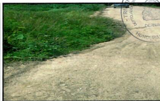
Ilustración 40. Necesidad de reparación de Borda entre Urraco y Monterey
