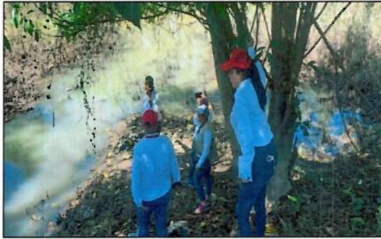
Ilustración 63. Necesidad de limpieza, desasolvamiento y mantenimiento del ancho de sección del cauce, Bordo Río Pelo
