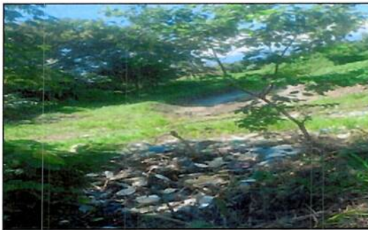
Ilustración 65. Necesidad de limpieza y remoción de residuos, Canal de Alivio Puente Plateado (Boquerón) y Canal Fátima
