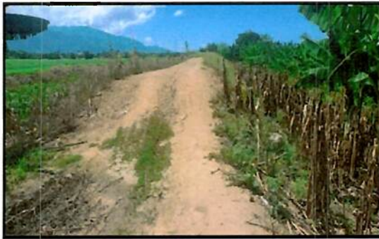
Ilustración 21. Necesidad de concluir elevación Bordo de Canal de Alivio Puente Plateado y Canal Fátima que intercepta con quebrada Corocol.
