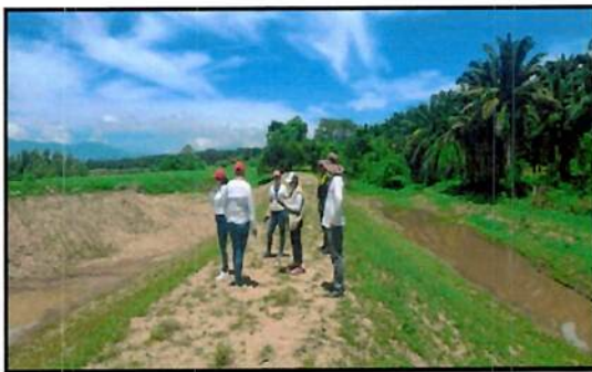
Ilustración 37. Necesidad de reparación de filtraciones en varios puntos del Bordo Río Ulúa margen derecho norte aguas abajo
