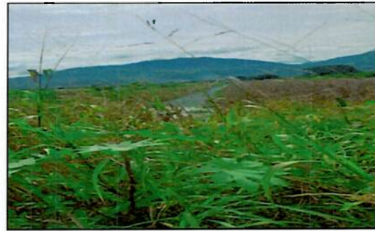
Ilustración 66. Necesidad de limpieza y mantenimiento del ancho de sección del cauce, Canal Guanchias y Canal Palermo
