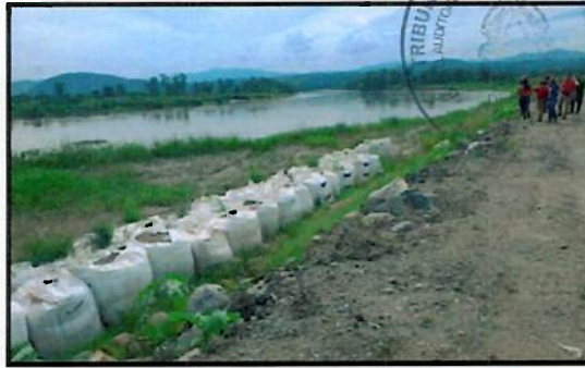
Ilustración 22. Necesidad de Obras de protección (escolleras) del Bordo Río Ulúa margen derecho norte y sur aguas abajo(en los meandros), entre finca 10 y 11
