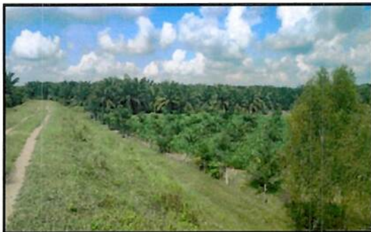
Ilustración 25. Necesidad de reparación por filtración en Bordo Bandera
