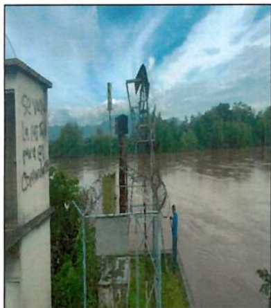
Ilustración 17. Estación que requiere cambio de cable vía y canasta.
