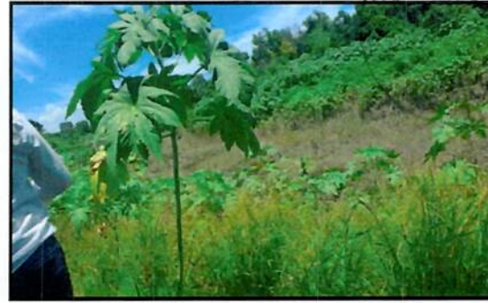
Ilustración 64. Necesidad de limpieza y mantenimiento del ancho de sección del cauce, Canal de Alivio Los Indios y Amapa
