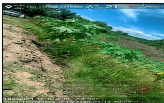
Ilustración 39. Necesidad de reparación y elevación del Bordo de Canal de Alivio Los Indios y Amapa
