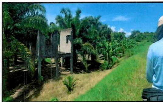
Ilustración 35. Necesidad de reparación de fisura en Bordo Río Ulúa, Colonia Omonita
