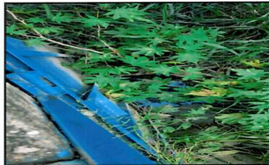
Ilustración 49. Necesidad de limpieza y remoción de residuos, Compuesta Canal Chotepe
