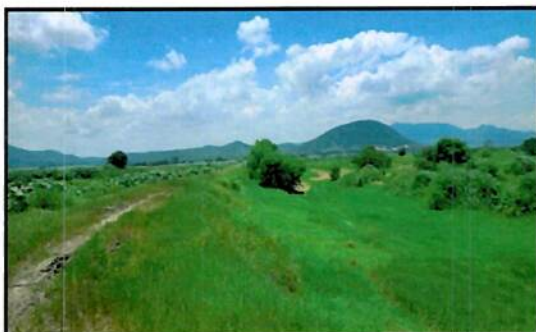
Ilustración 29. Necesidad de reparación por hundimiento de corona de Bordo Canal Maya
