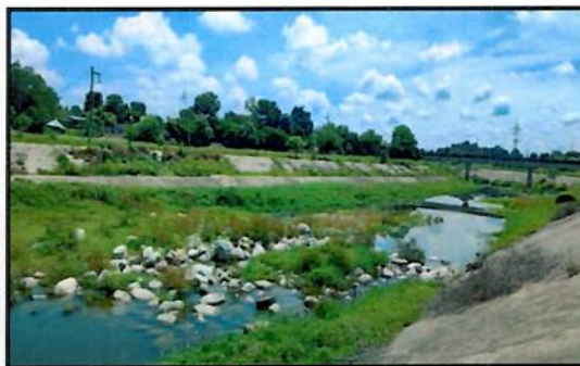
Ilustración 42. Necesidad de limpieza del cauce, Canal Choloma Centro
