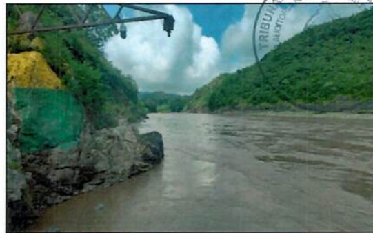
Ilustración 13. La canasta y cable vía para poder aforar están dañados.
