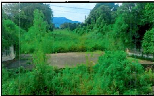
Ilustración 57. Necesidad de desasolvamiento, limpieza y reactivación del cauce, Canal, Marimba
