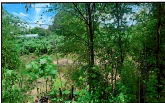
Ilustración 59. Necesidad de limpieza de material vegetativo no deseado, Bordo del Canal Maya
