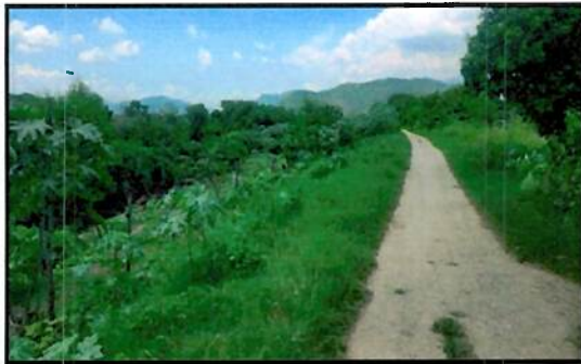
Ilustración 19. Necesidad de construcción de gaviones en el Bordo del Sector Valle Escondido
