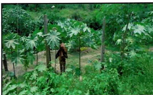
Ilustración 32. Necesidad de reparación de talud en Bordo Canal Chotepe
