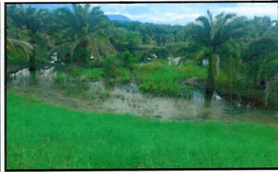
Ilustración 38. Necesidad de reparación de filtraciones en varios puntos del Bordo Río Ulúa margen derecho sur aguas abajo
