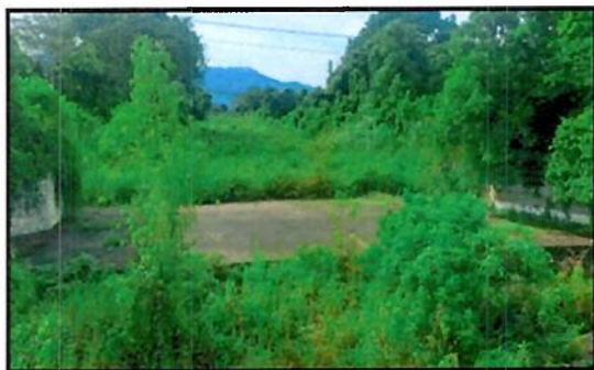
Ilustración 8. Necesidad de desasolvamiento, limpieza y reactivación del cauce, Canal, Marimba
