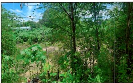
Ilustración 10. Necesidad de limpieza de material vegetativo no deseado, Bordo del Canal Maya
