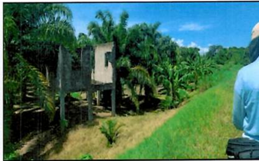
Ilustración 2. Necesidad de reparación de fisura en Bordo Río Ulúa, Colonia Omonita
