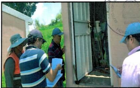
Ilustración 4. Necesidad de reparación de bomba de elevación del bordo Sector La Mesa/Álvaro Martínez
