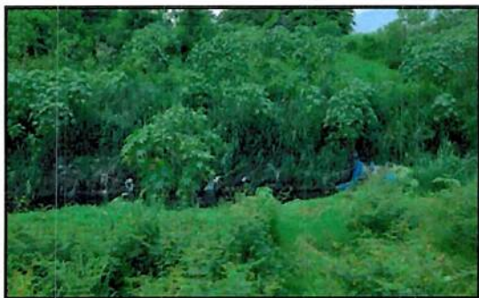
Ilustración 14. Necesidad de desasolvamiento y mantenimiento ancho de sección, Canal San Carlos
