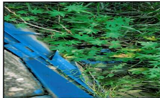
Ilustración 12. Necesidad de limpieza y remoción de residuos, Compuerta Canal Chotepe
