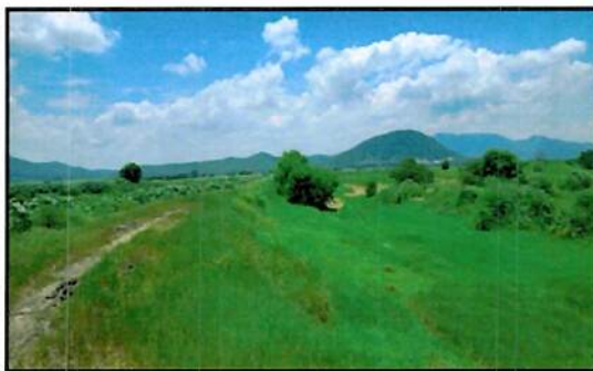
Ilustración 3. Necesidad de reparación por hundimiento de corona de Bordo Canal Maya
