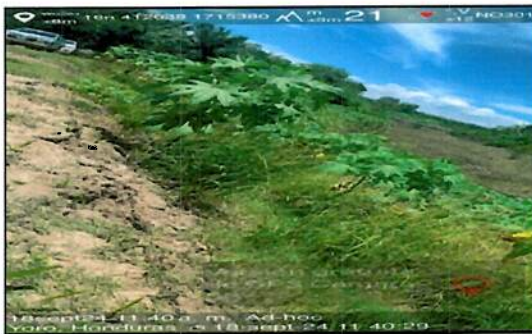
Ilustración 7. Necesidad de reparación y elevación del Bordo de Canal de Alivio Los Indios y Amapa
