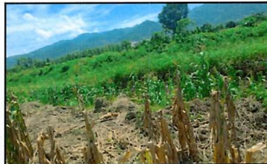
Ilustración 10. Necesidad de limpieza y mantenimiento del ancho de sección del cauce, Bordo Río Ulúa margen derecho sur
