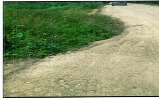
Ilustración 8. Necesidad de reparación de Borda entre Urraco y Monterey
