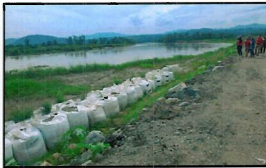
Ilustración 2. Necesidad de Obras de protección (escolleras) del Bordo Río Ulúa margen derecho norte y sur aguas abajo(en los meandros), entre finca 10 y 11
