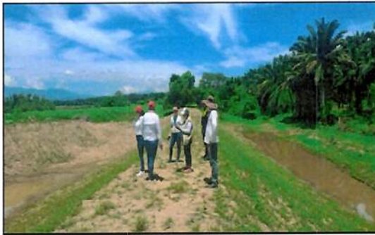
Ilustración 5. Necesidad de reparación de filtraciones en varios puntos del Bordo Río Ulúa margen derecho norte aguas abajo
