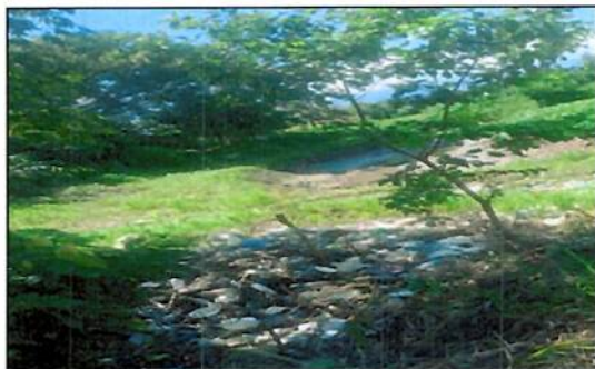
Ilustración 13. Necesidad de limpieza y remoción de residuos, Canal de Alivio Puente Plateado (Boquerón) y Canal Fátima
