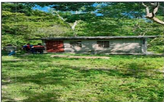
Ilustración 7. Estación Climatológica vandalizada.
