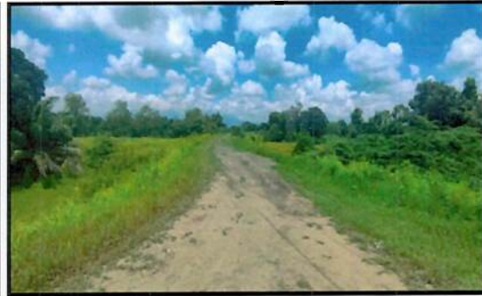
Ilustración 4. Necesidad de reparación por filtración en Bordo La Ceibita
