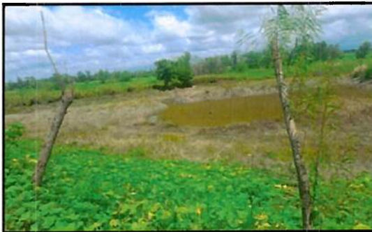
Ilustración 3. Necesidad de reparación por filtración en Bordo Montañuela
