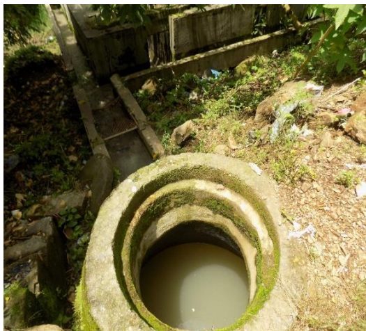
Zanjas donde se conduce las aguas negras, hacia el cuerpo receptor
