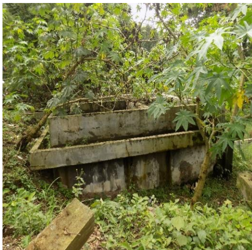
Pila receptora de aguas negras
